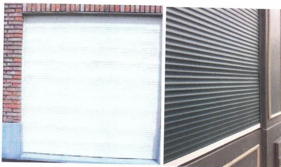
Figure 1 – Ondulation de tabliers de volets roulants
